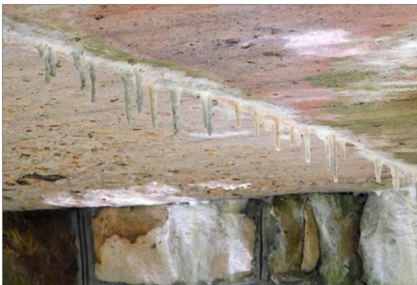
Fot. 7. Na dolnych powierzchniach dźwigarów wykształciła się antropogeniczna szata naciekowa (BK)
