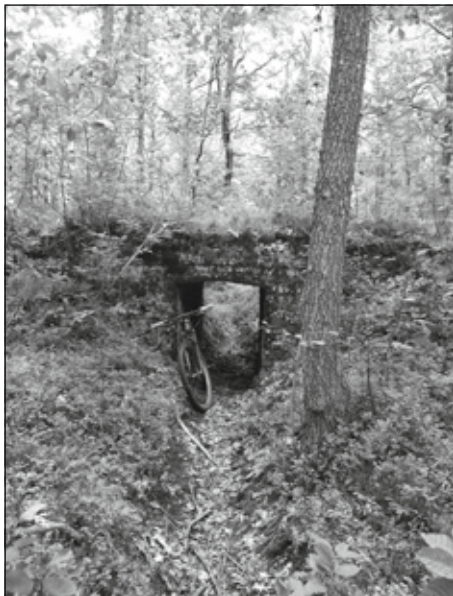
Przepust pod nasypem dawnej kolejki wąskotorowej z Suchedniowa na Świnia Górę, stan obecny. fot. P. Kardyś.
