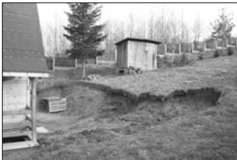
Fot. 3. Spływ ziemny na działce rekreacyjnej. Suchedniów (WBi)
