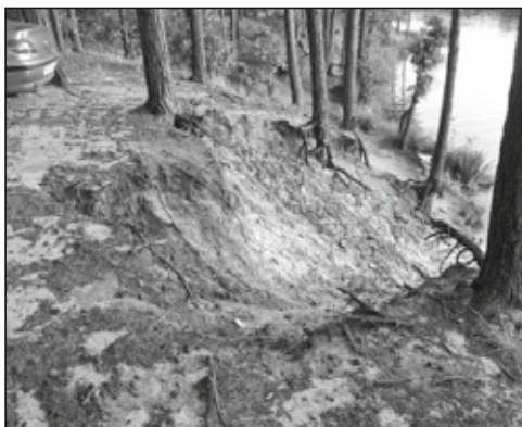
Fot. 10. Nisza osuwiskowa na skarpie Jeziora Rejowskiego (WB)
